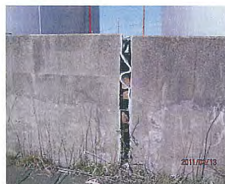
・亀裂の入った燃油タンクの防油堤
