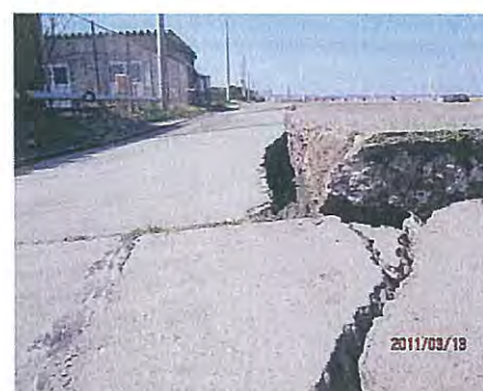
・液状化による岸壁の亀裂
