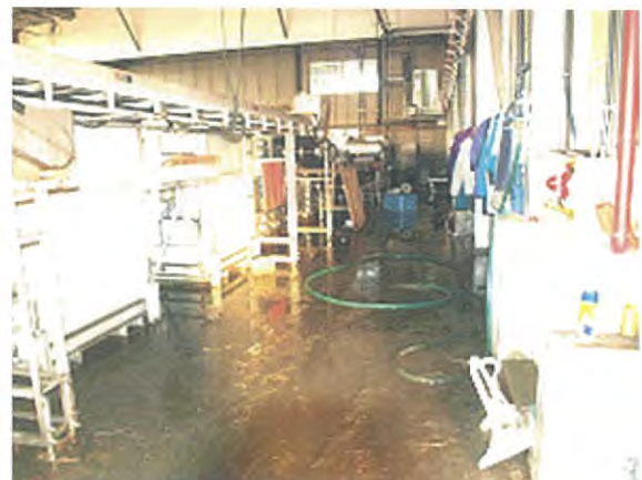
2 冷凍・冷蔵施設(脱パン機器) (海水に浸かる)
