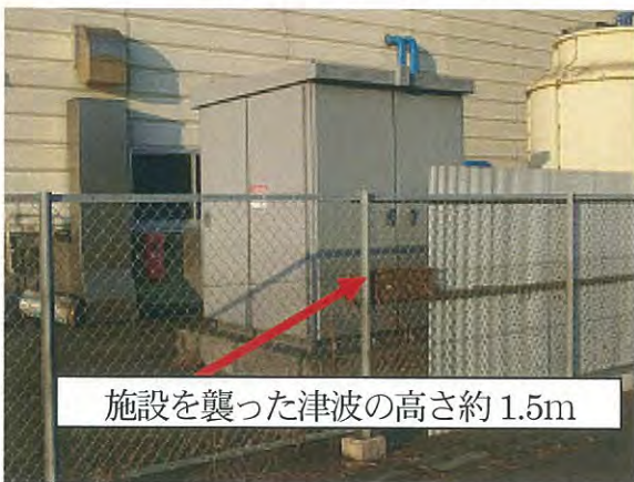
3 冷凍・冷蔵施設の電気設備
