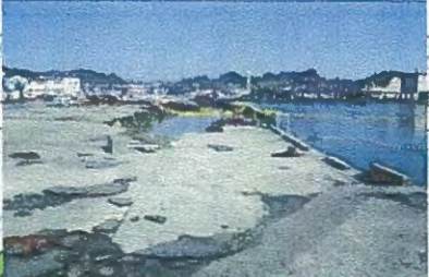
工事番号20号(-5m岸壁)の被災状況
