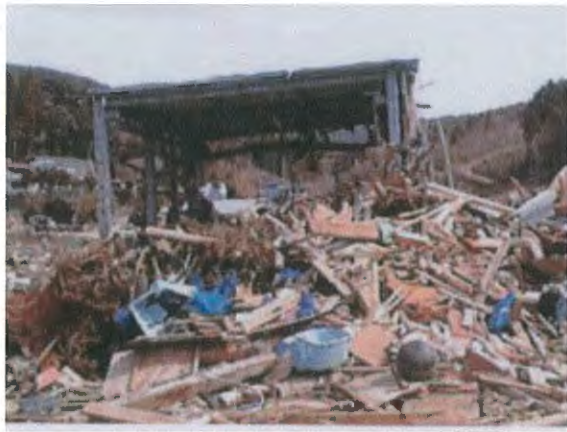
津波の直撃を受けた漁具資材倉庫
