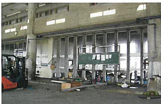
※魚市場建物を津波が突き抜ける
