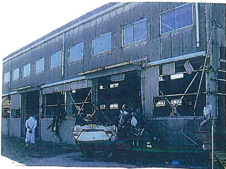
津波で損壊した倉庫
