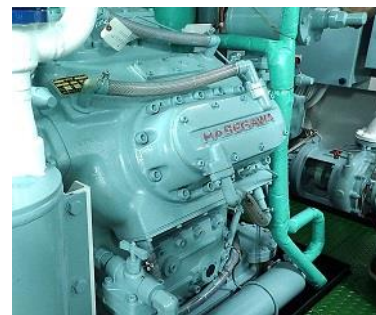
新船 75kW圧縮機×2機 30.80RT (冷凍能力)
